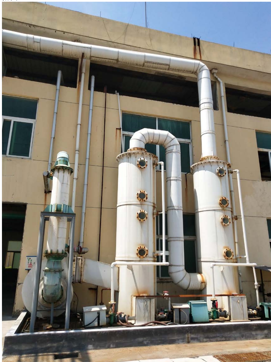
附图 1 500t/a 叠氮化钠车间废气预处理装置
